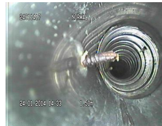
Schroef door rookgasbuis
