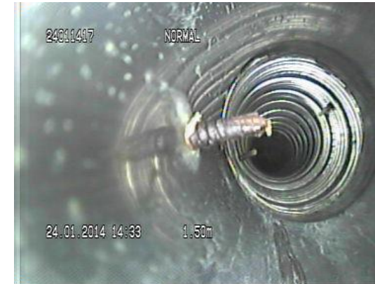
Schroef door rookgasbuis
