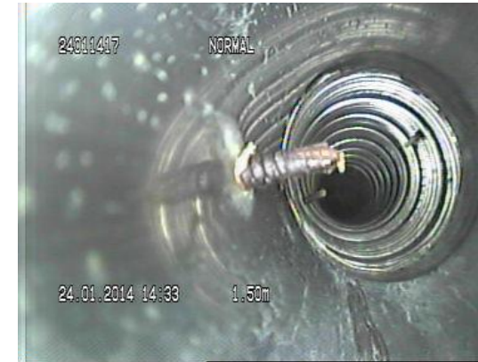
Schroef door rookgasbuis
