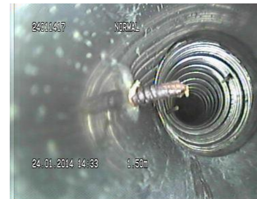
Schroef door rookgasbuis
